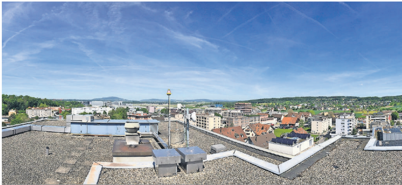
Wird saniert: Das teilweise undichte Flachdach auf dem Stadthaus in Kloten.
